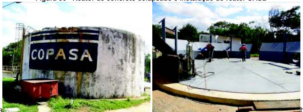
Figura 86 - Reator de concreto colapsado e instalação do reator UASB
