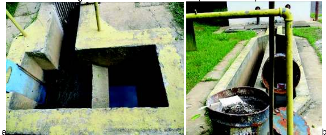
Figura 87 - Tratamento Preliminar (ETE Vila Maria)
