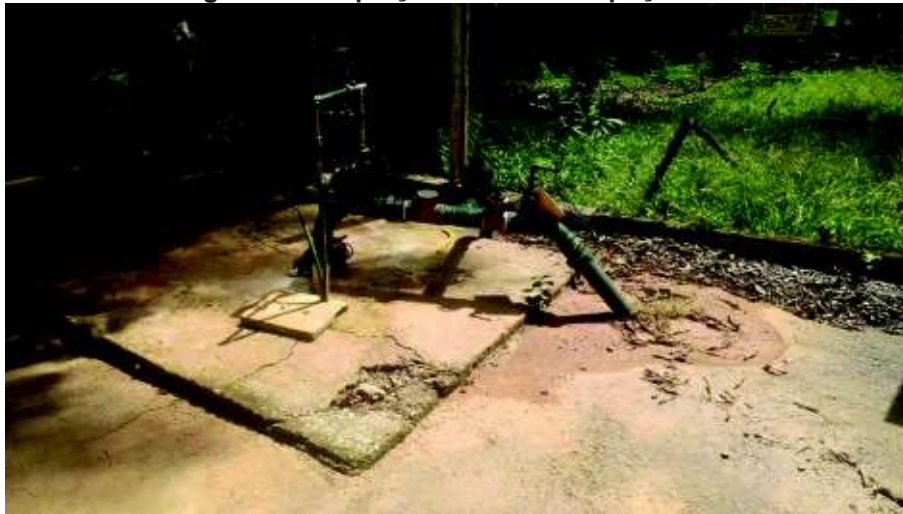
Figura 59 - Captação subterrânea poço C-15
