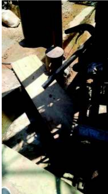
Figura 43 - Captação subterrânea poço Lagoa Mansões
