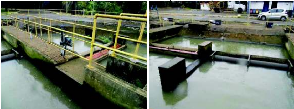
Figura 81 - Decantadores (ETE Central)
