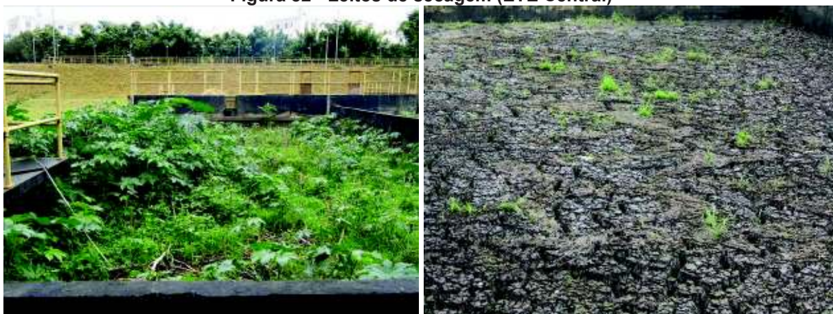
Figura 82 - Leitos de secagem (ETE Central)
