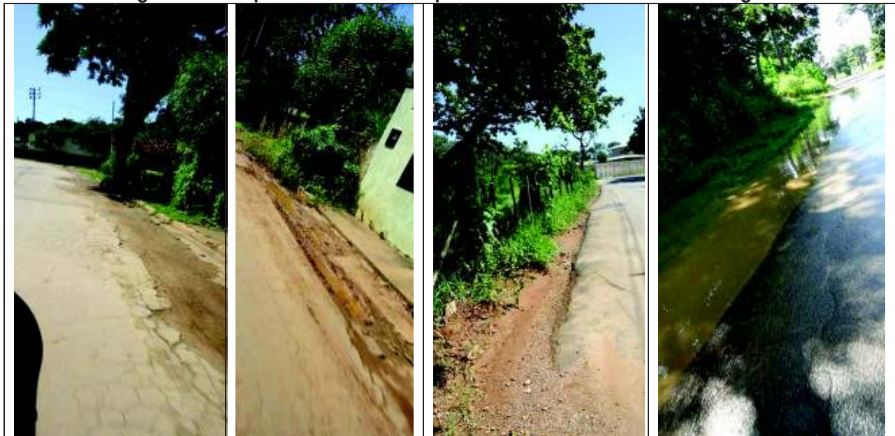
Figura 206 - Aspectos das vias e impactos da ausência de microdrenagem
