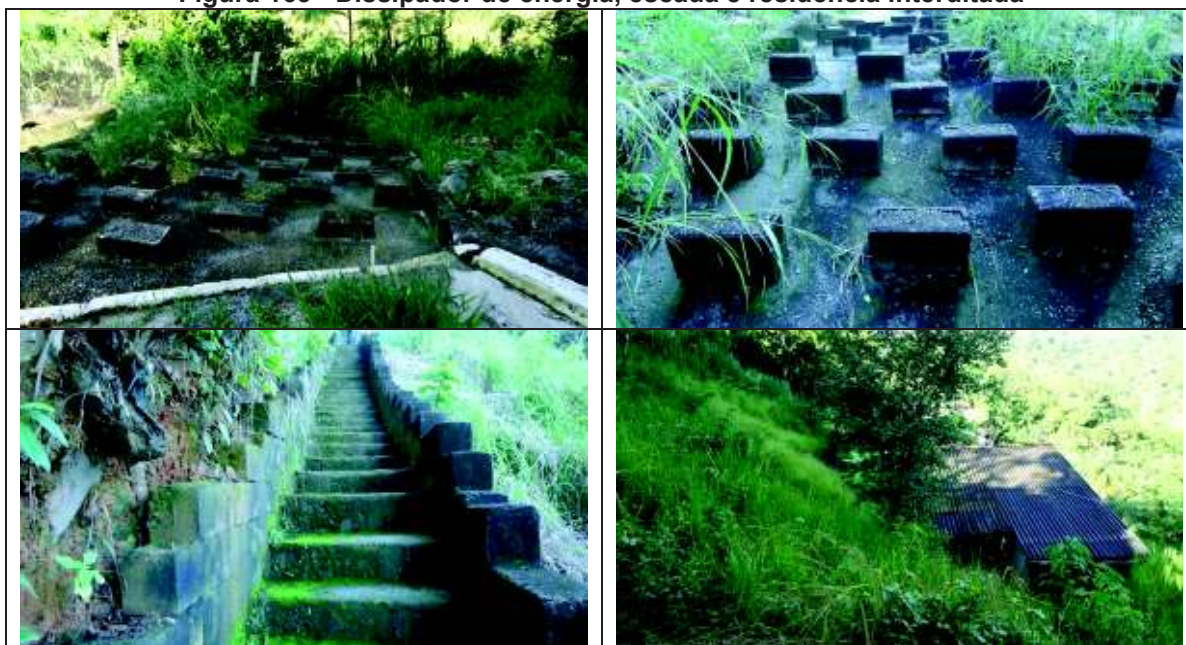
Figura 163 - Dissipador de energia, escada e residência interditada
