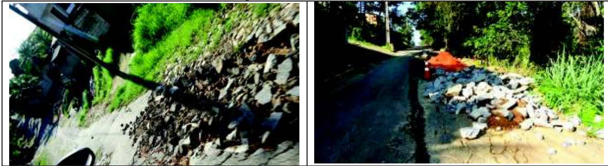
Figura 160 - Erosão na pavimentação
