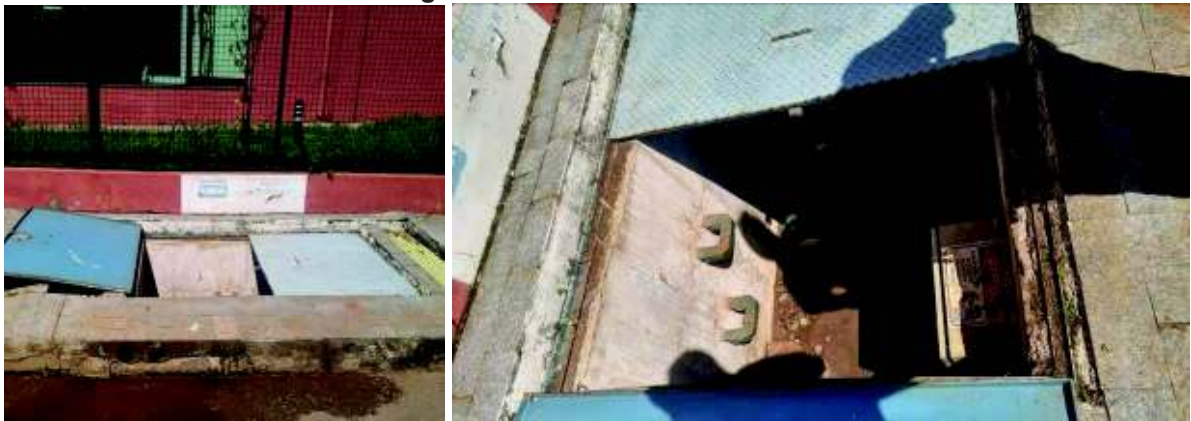
Figura 36 - Booster Bela Vista II
