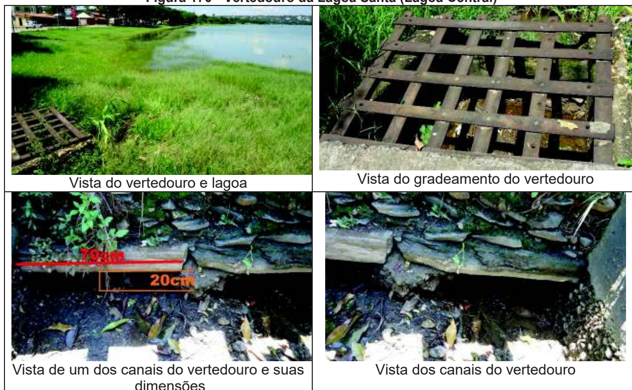
Figura 170 - Vertedouro da Lagoa Santa (Lagoa Central)
