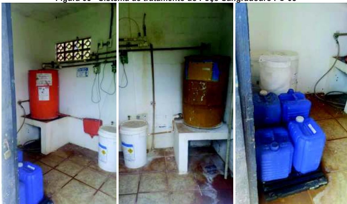
Figura 65 - Sistema de tratamento do Poço Sangradouro PC-03
