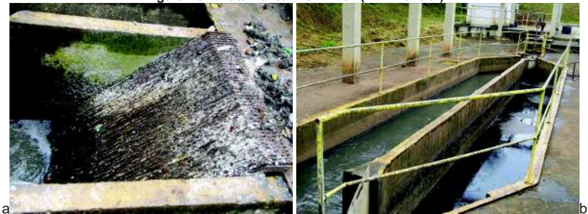
Figura 78 - Tratamento Preliminar (ETE Central)
