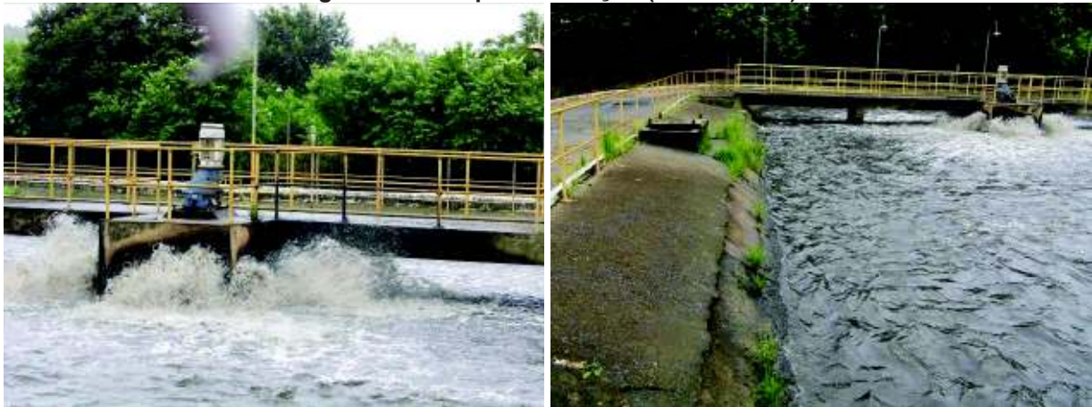
Figura 80 - Tanque de aerção (ETE Central)
