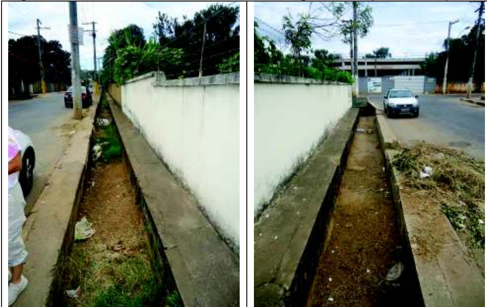
Figura 125 - Vista da estrutura de microdrenagem inadequada, à esquerda
