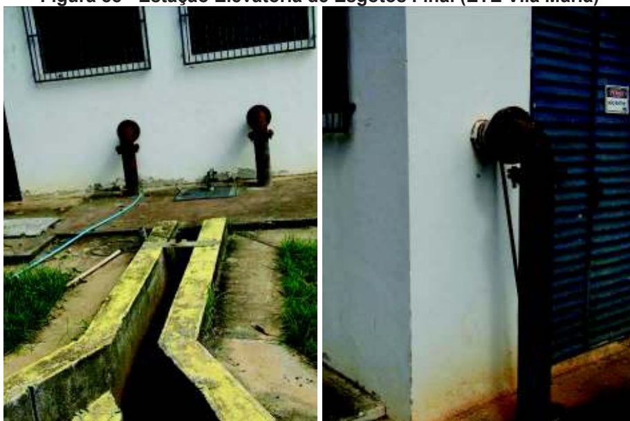
Figura 88 - Estação Elevatória de Esgotos Final (ETE Vila Maria)
