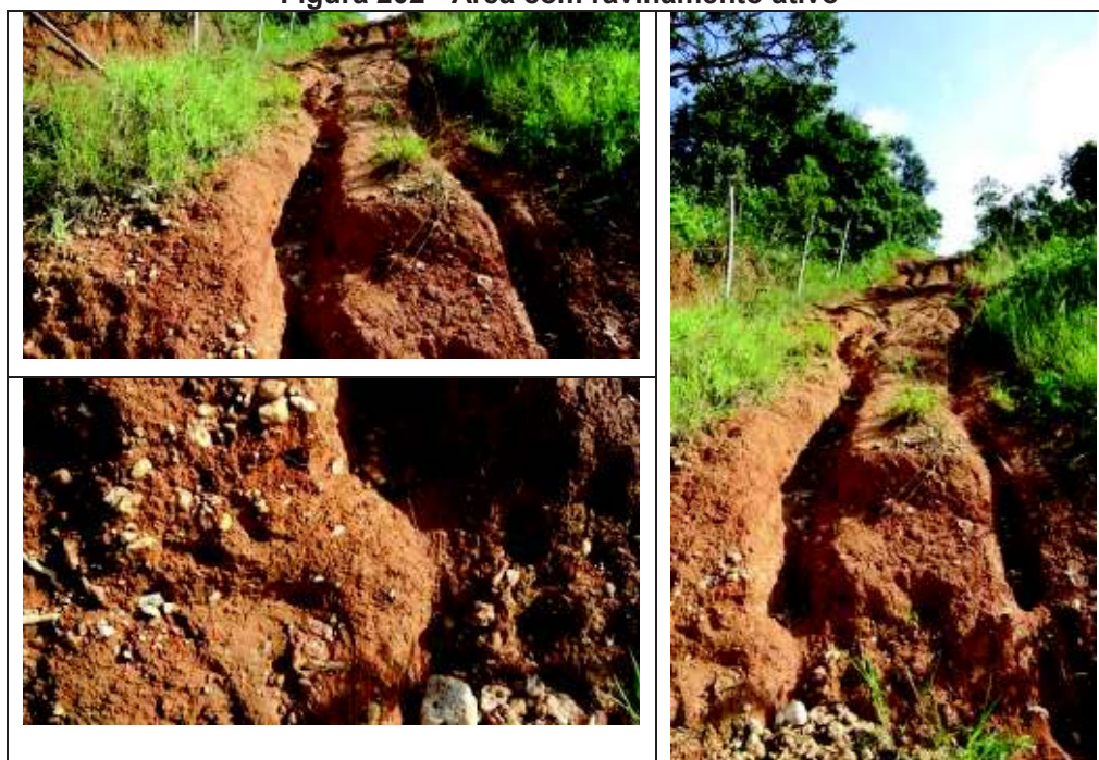
Figura 202 - Área com ravinamento ativo
