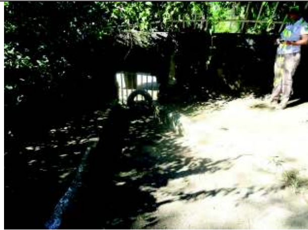
a – Entrada das águas- Rua Aeroporto
