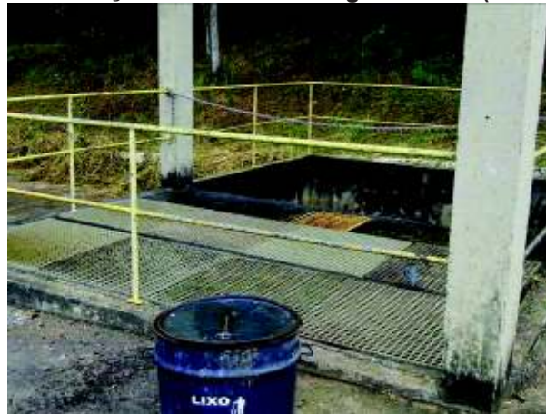
Figura 79 - Estação Elevatória de Esgotos Final (ETE Central)
