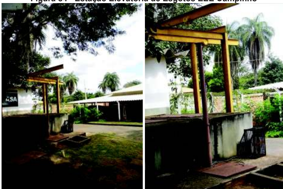
Figura 84 - Estação Elevatória de Esgotos EEE Campinho
