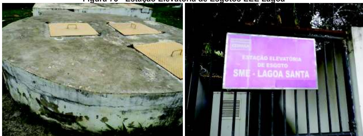
Figura 73 - Estação Elevatória de Esgotos EEE Lagoa
