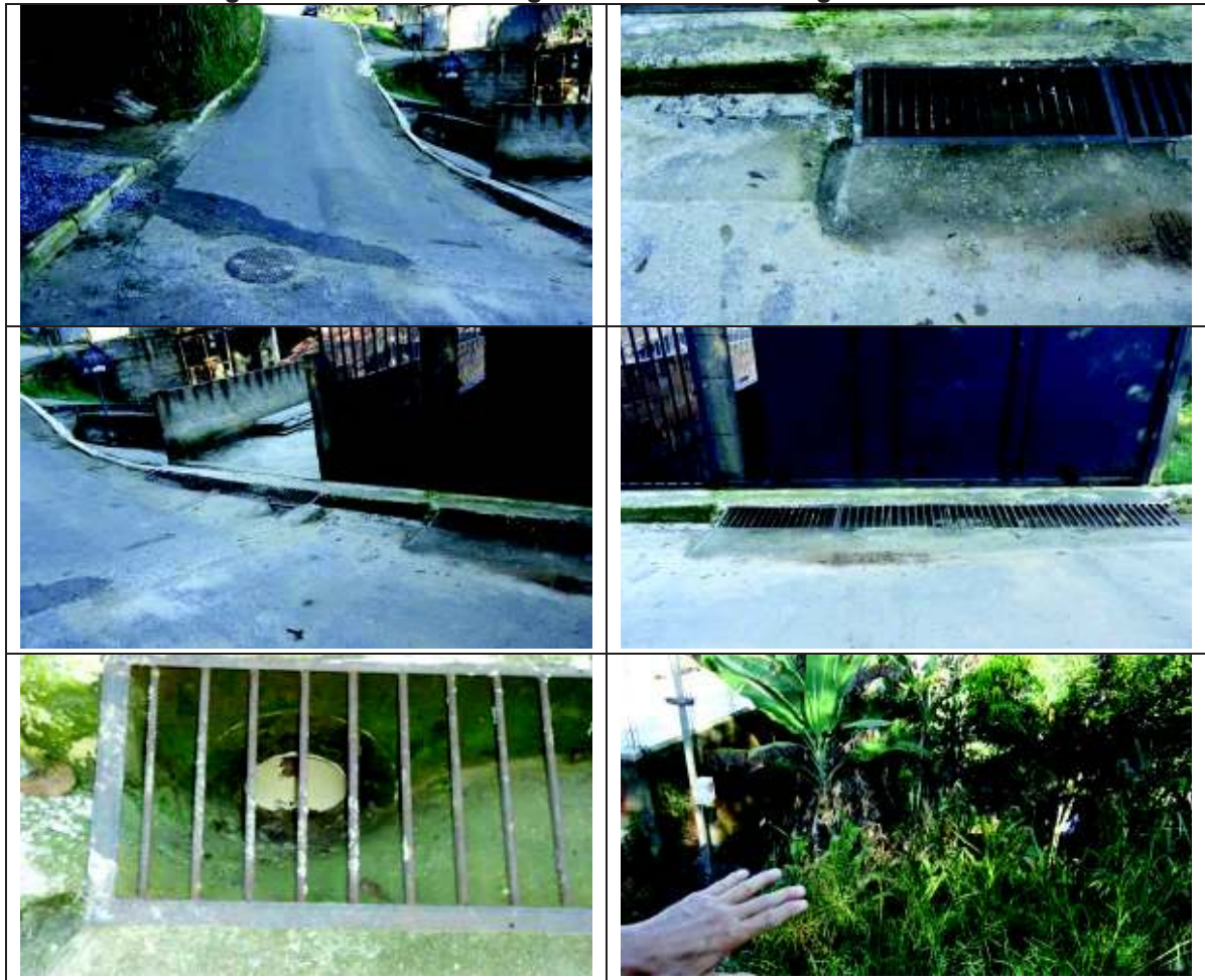
Figura 161 - Área de talvegue associado a drenagem ineficiente
