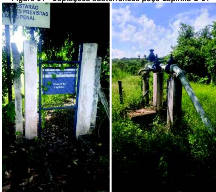
Figura 61 - Captações subterrâneas poço Lapinha C-01
