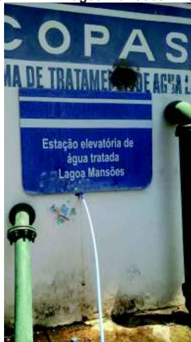
Figura 54 - EEAT Lagoa Mansões - Desativada
