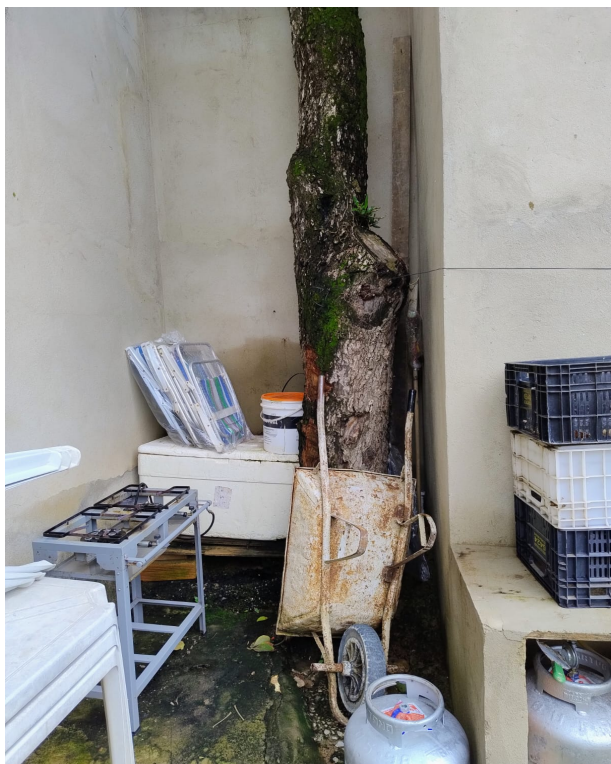
Foto 03: Detalhe da proximidade do tronco à parede.
