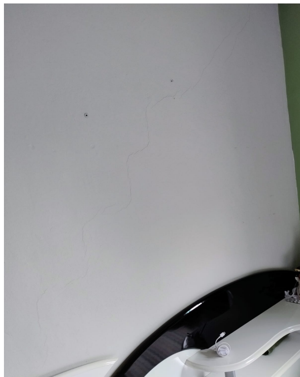
Foto 04: Fissura na alvenaria, parte interna do quarto.
